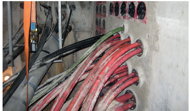
Stanje cjevovoda nakon sanacije: Ugrađeni su rezervni uvodi. Oko položenih kabela ugrađene su razdijeljene proturne cijevi. Tako se osigurala nepropusnost od zida preko proturne cijevi do kabela.
