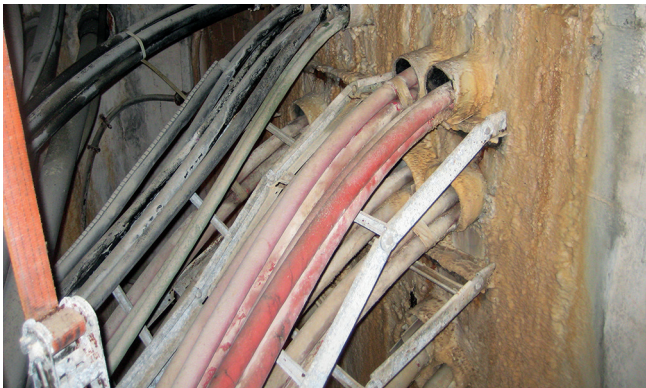
Stanje cjevovoda prije sanacije: Voda je prodirala između zaštitnih cijevi i kabela te između zaštitnih cijevi i zida.
