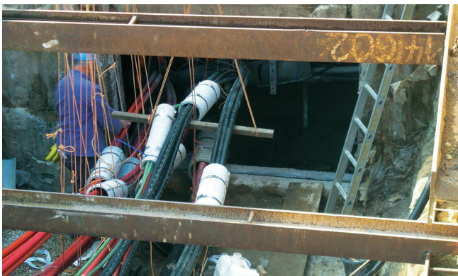
Okolo položenog kabela i zaštitne cijevi napravljeno je udubljenje te je oko svakog sustava kabela ugrađena proturna cijev.
